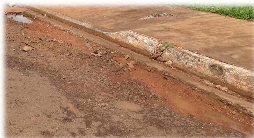
Figura 3 – Pavimento com defeito na Rua Santo Ângelo (Bairro Milane) e sarjeta intacta.
