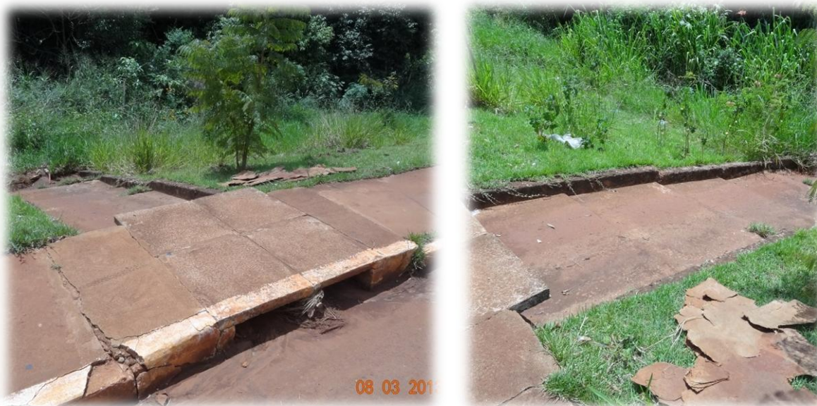
Figura 20 - Dispositivo de captação de águas pluviais (à esquerda) e seu respectivo dissipador de energia, evitando erosão no ponto de lançamento (à direita).
