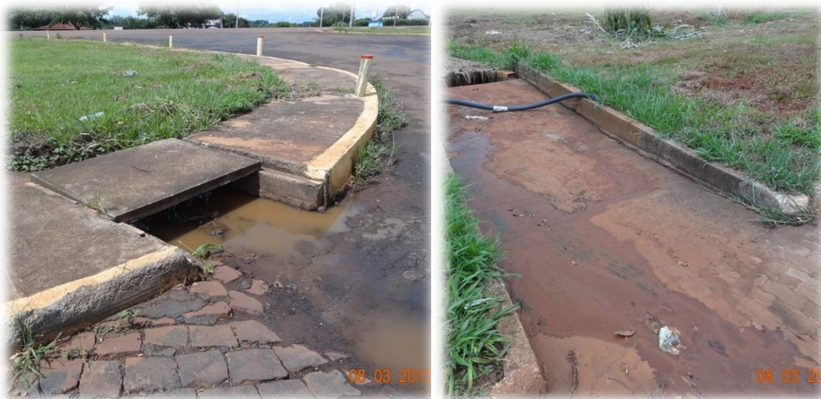
Figura 17 – Dispositivos de captação que conduzem as águas pluviais até o canal de drenagem sem revestimento.
