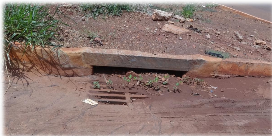
Figura 11 - Boca de lobo obstruída, localizada na Rua Uirapuru próximo ao cruzamento com a Rua das Gaivotas.
