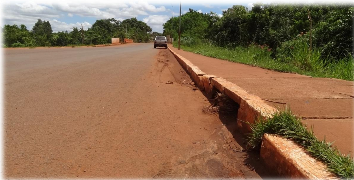
Figura 19 - Dispositivo de captação de água próximo à ponte sobre o Córrego Capão Redondo na Av. Mato Grosso do Sul.
