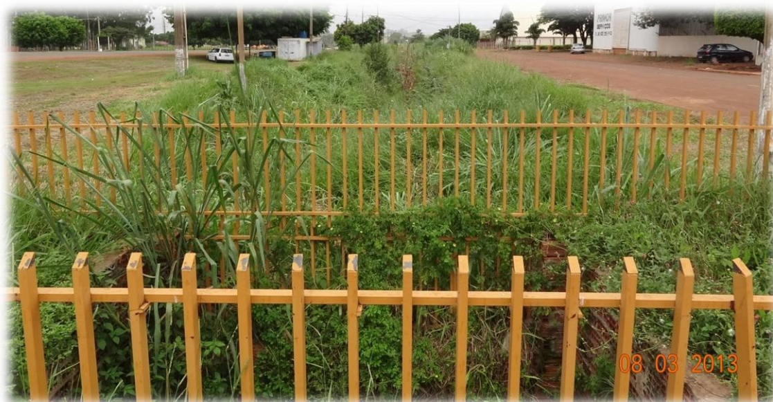
Figura 16 - Canal de drenagem sem revestimento localizado entre a margem da BR-163 e Rua Elvino Ramos Nogueira
