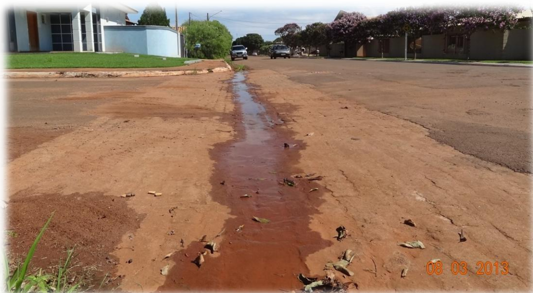
Figura 6 - Linhas d'água (depressões) com o leito confeccionado em paralelepípedo presente nos cruzamentos de algumas ruas do município de São Gabriel do Oeste/MS.
