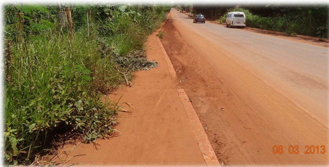
Figura 5 – Acúmulo de sedimentos nas sarjetas próximo à ponte sobre o Córrego Capão Redondo.
