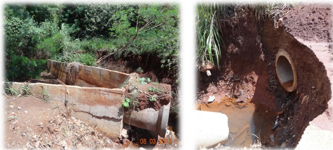
Figura 14 – Detalhe do muro de ala no ponto de lançamento de águas pluviais (à esquerda) que apresentou problemas devido à sobrecarga do sistema e ocasionou o rompimento das tubulações de concreto (à direita).
