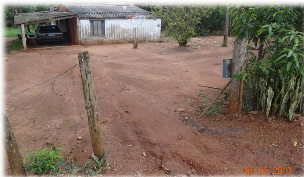
Figura 22 Morador do Bairro Milane, próximo à margem do Rio Coxim, que eventualmente é atingido por águas de enxurradas que atravessam a guia rebaixada e erodem sua propriedade.
