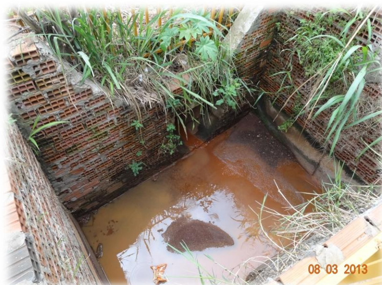
Figura 18 - Detalhe da caixa de passagem (sem cobertura), que dá acesso ao canal de drenagem às margens da rodovia BR-163.
