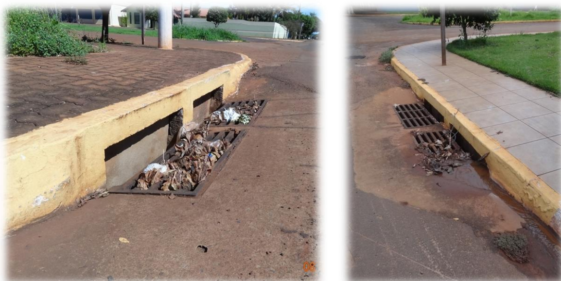
Figura 10 - Bocas de lobo do tipo "combinada múltipla" com a presença de material (resíduos) retido nas grelhas.
