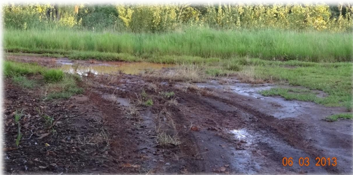
Figura 30 – Ponto de atoleiro verificado no Distrito Ponte Vermelha.
